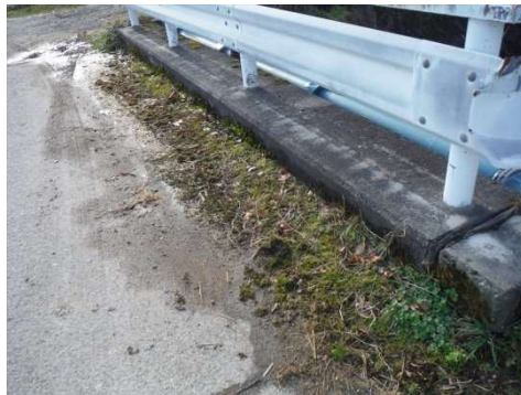
（路肩部における土砂堆積）
