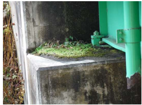
（橋座面における土砂堆積）
