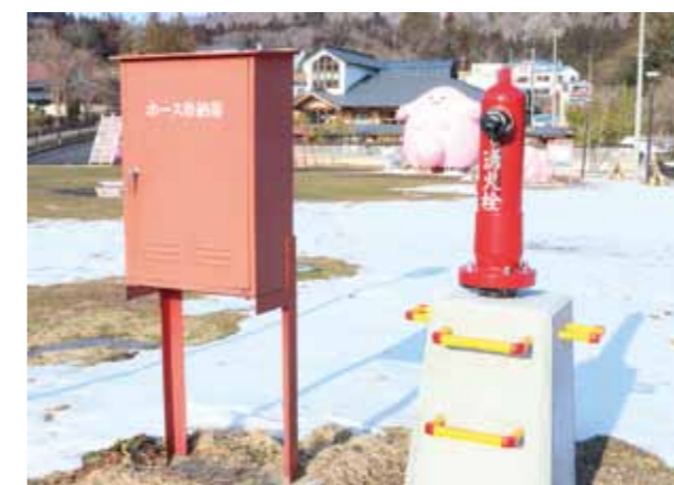
▲令和5年度に改修した地上式消火栓 (消火栓新設・改修事業)
