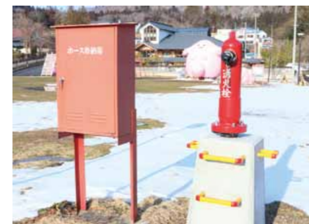
▲令和5年度に改修した地上式消火栓 (消火栓新設・改修事業)
