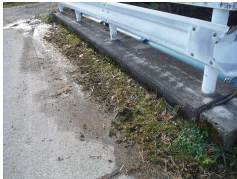
（路肩部における土砂堆積）
