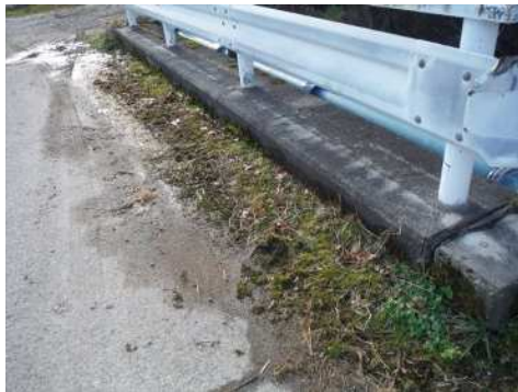
（路肩部における土砂堆積）
