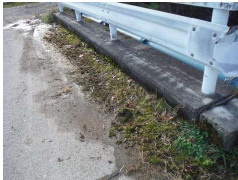
（路肩部における土砂堆積）
