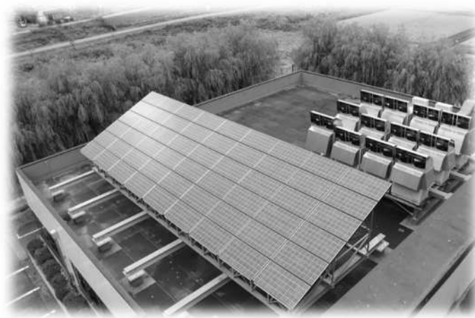
役場に設置してある太陽光パネル
