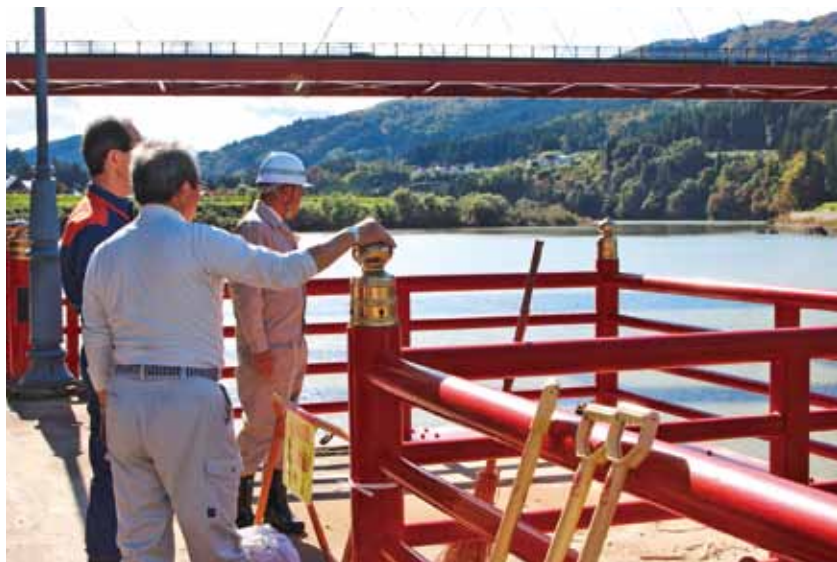
“魚淵” 被害状況：只見川の増水により東屋が流出
