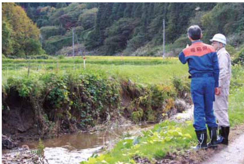
“準用河川龍蔵庵川” 被害状況：増水により護岸が2.5m崩落
