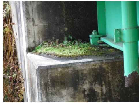
（橋座面における土砂堆積）
