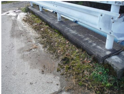
（路肩部における土砂堆積）
