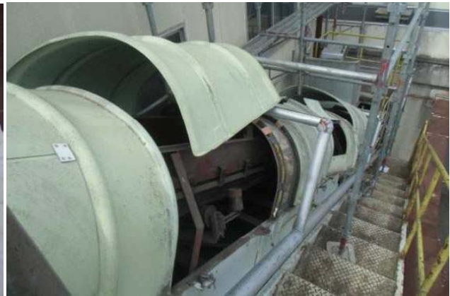
爆発により破損した搬出コンベア
