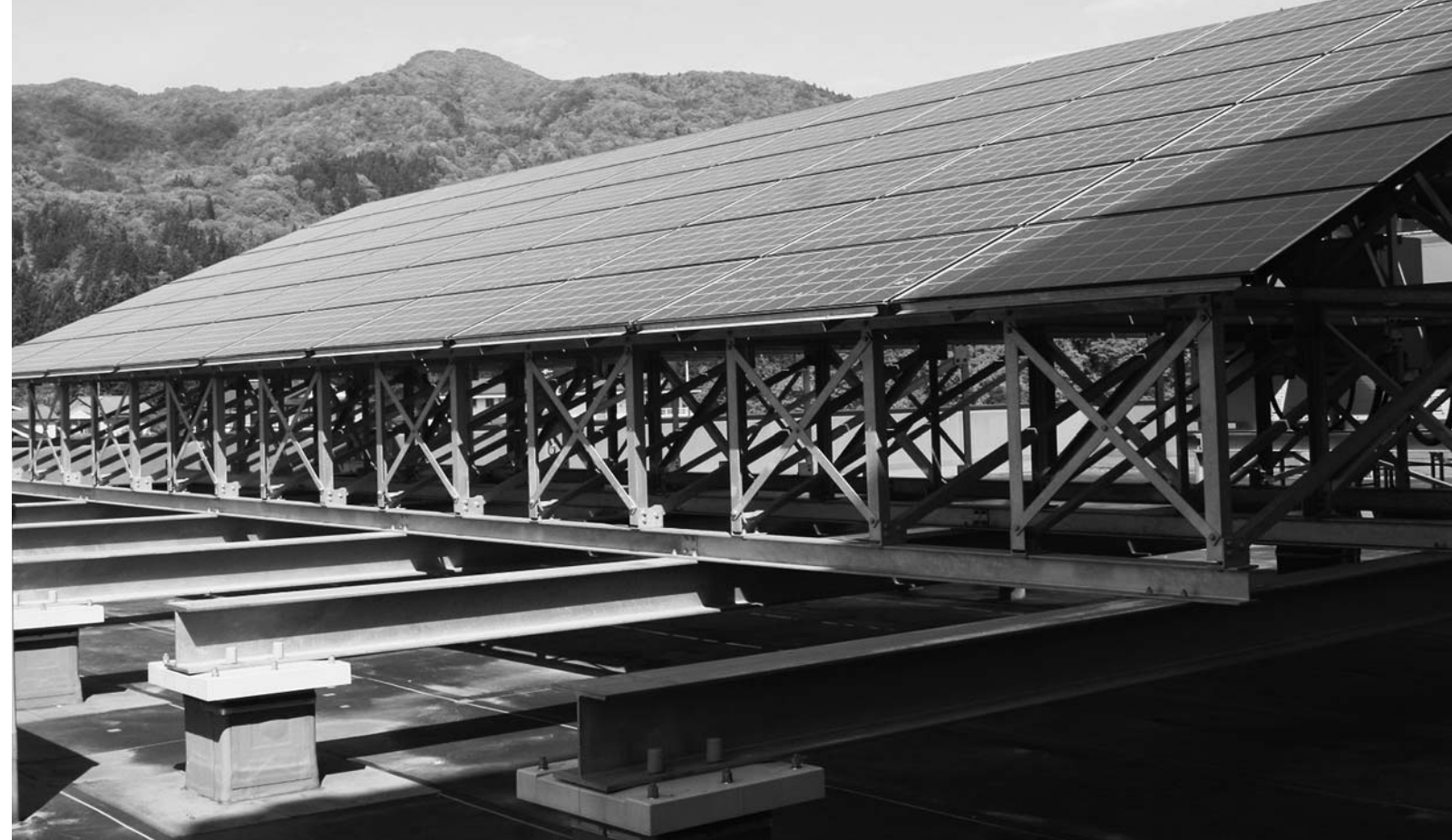
役場屋上にある太陽光パネル(出力10kw)
