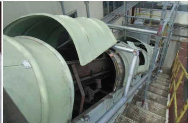
爆発により破損した搬出コンベア
