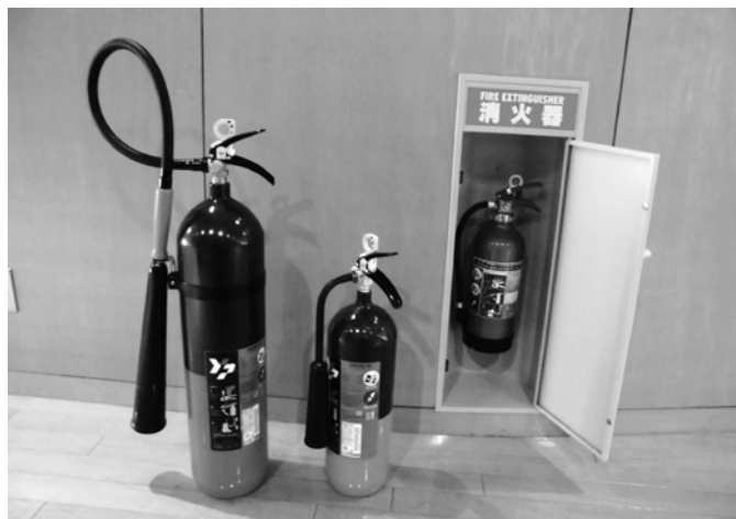
美術館に設置されている消火器
